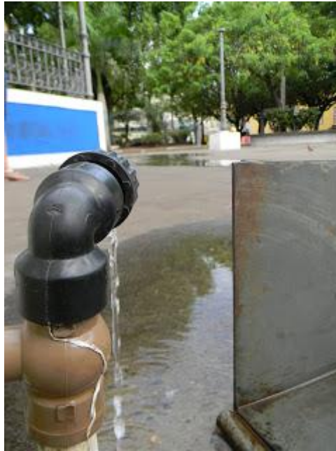
Figura 07: Cano danificado na praça localizado ao lado do coreto.
